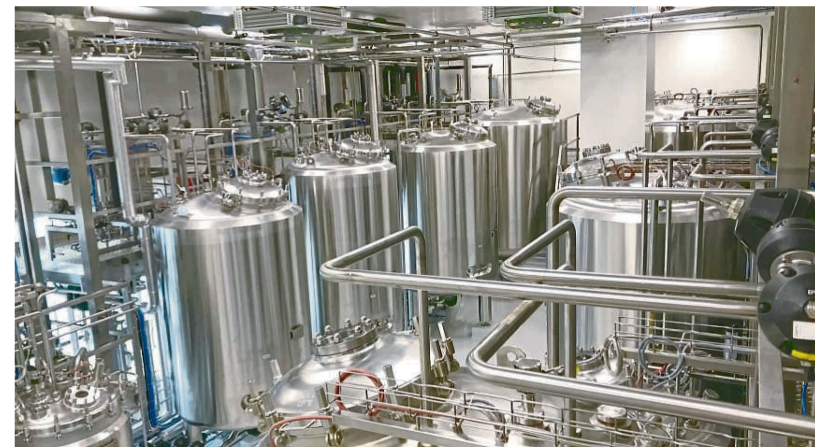
Das Pufferlager für Immunglobuline im neuen Biotest-Gebäude. Das Medikament kommt bei Antikörpermangel zum Einsatz.
